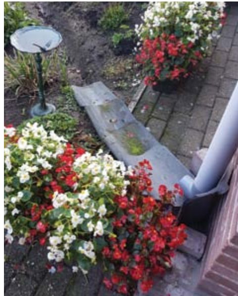
Border Let op! Het water stroomt hier naar een border die te dicht bij de gevel ligt. Het water moet minimaal 2 meter van de gevel de grond in gaan
